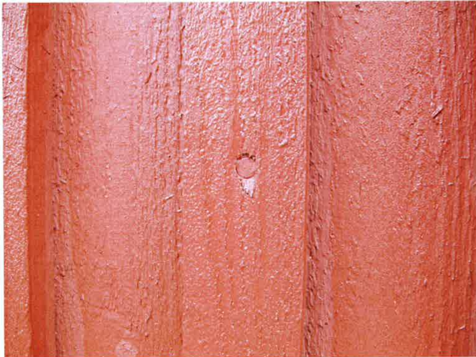
Figur 26 Grunt spikhål, men tydlig skada på pannelsytan.
