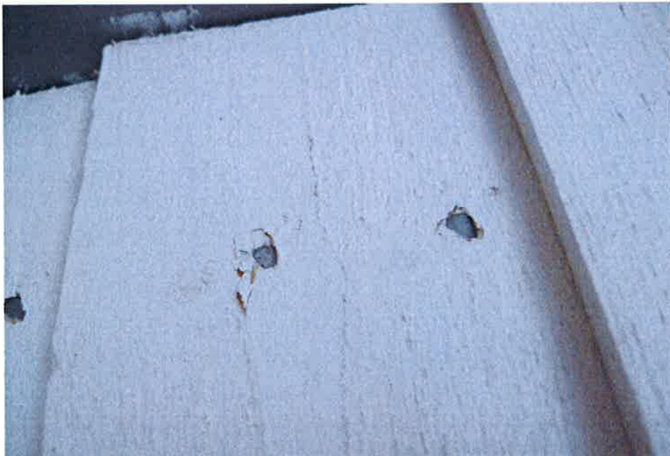
Figur 25 Djup spikning där intilliggande panelyta skadats intill kvistar.
