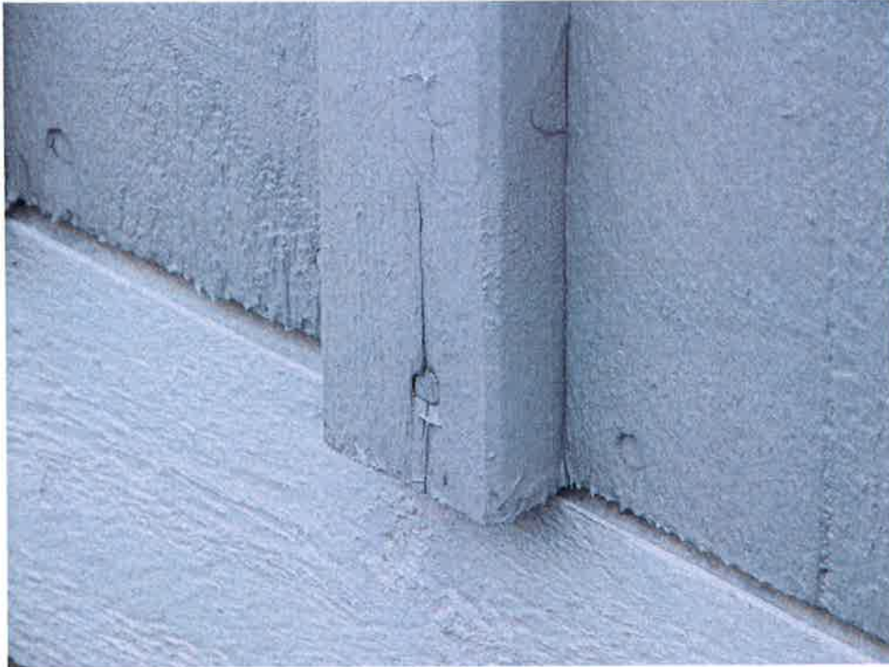
Figur 34 Grunda spikhål, men mycket nära panel- och liständar, vilket gett en spricka i ett fall.
