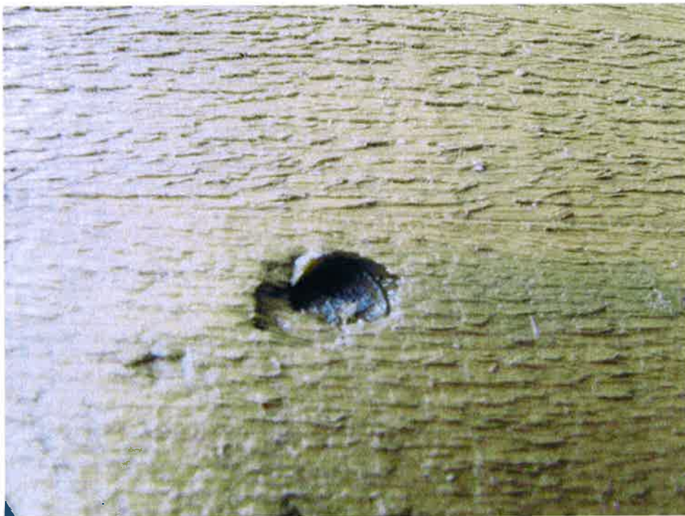
Figur 36 Ett djupt spikhål i liggande panel med skador på panelytan.
