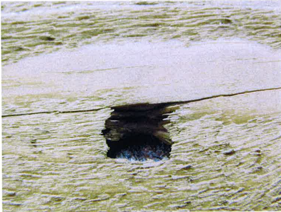
Figur 39 Mycket djupt spikhål intill en spricka som förstorat skadan i virket.
