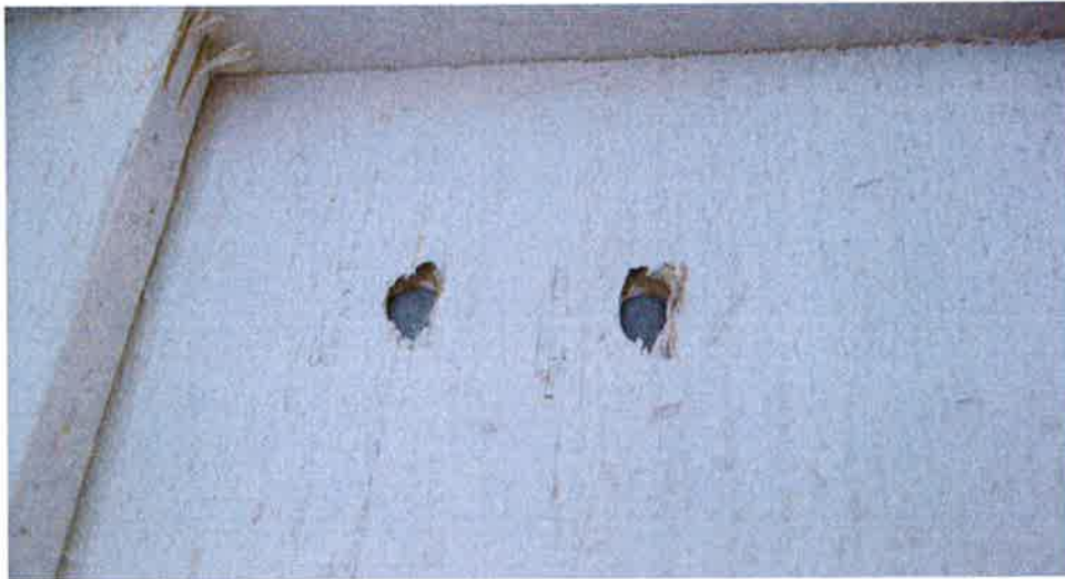
Figur 24 Djupa spikhål före färdigstrykning där det syns tydligt hur ändträ blottats i spikhålen.
