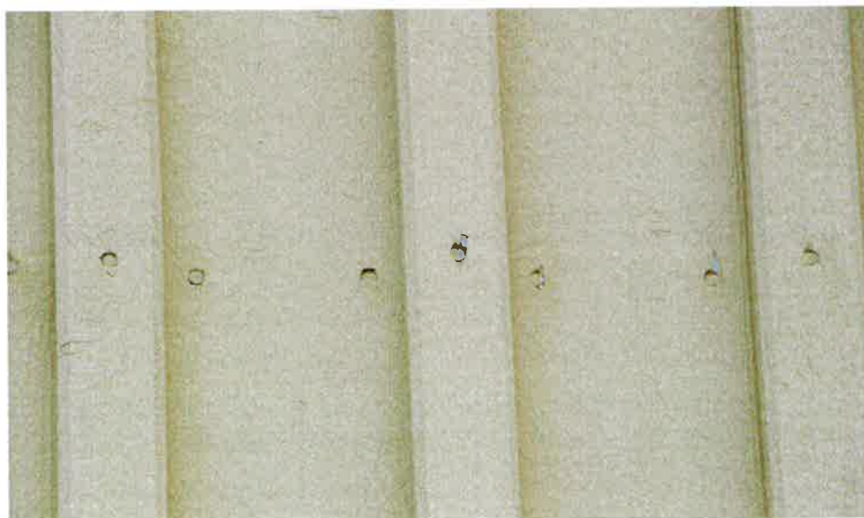
Figur 31 Närbild av fasaden i figur 30 med varierande djup hos spikhålen. Flisor har lossnat från ett par av spikhålen.
